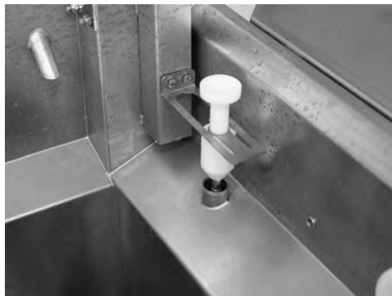
obraz 31 Kran przelewowy
