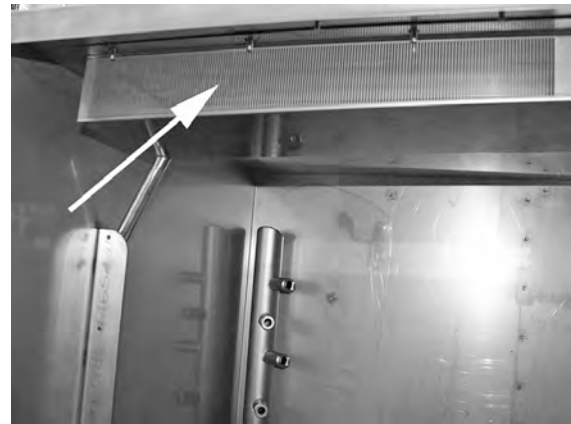
Photo 34 EcoExchanger vu de l'intérieur de la cuve
