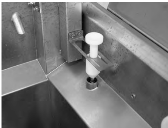
εικόνα 30 Βρύση σε περίπτωση υπερχειλίσσης
