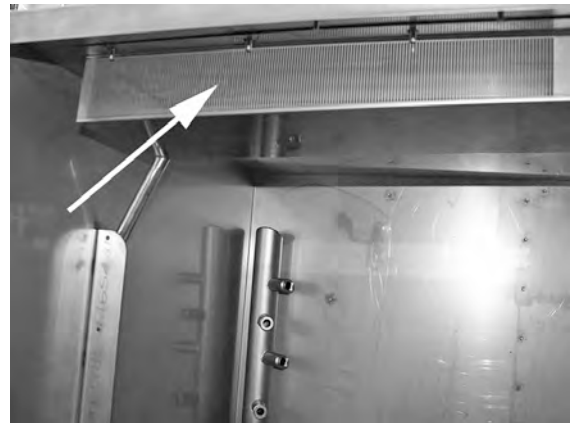
Imagen 41 EcoExchanger visto en el interior de la cabina de la máquina
