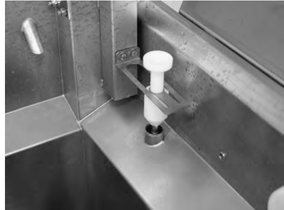
Photo 33 Robinet du trop-plein
